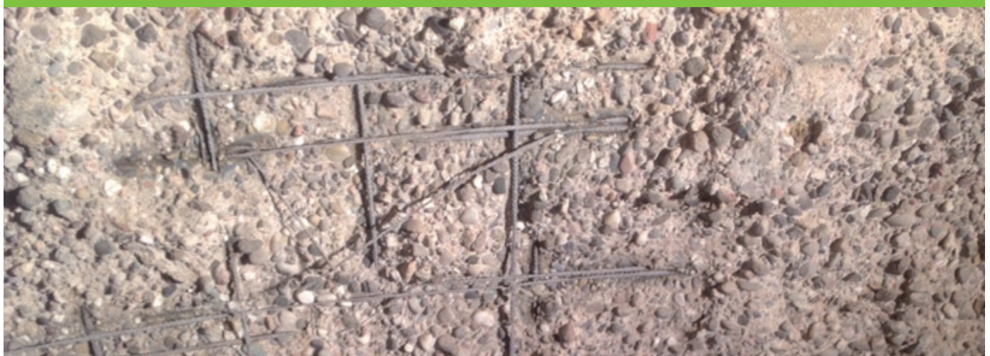
Massive Betonauswaschungen, hervorgerufen durch biogene Säurekorrosion (BSK)
